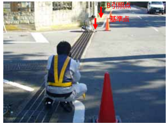
A引照点での基準器による視準(A引照点～基準点～B引照点)
