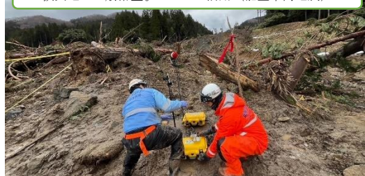
被災地での崩落監視システム活用 (能登半島地震)
